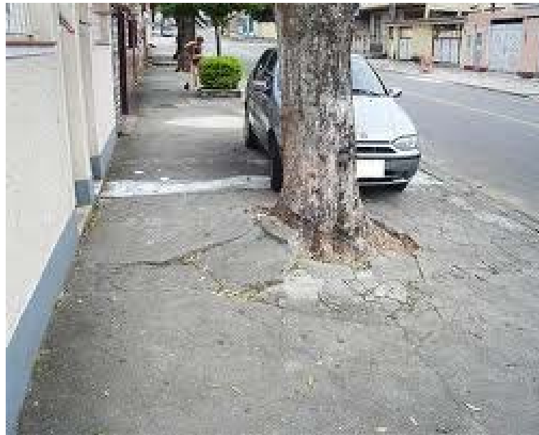
Figura 4.7 - Exemplo de área de infiltração inadequada.
